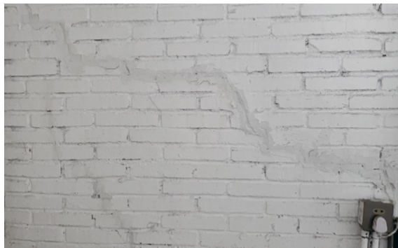
拍摄于诉中,出租人为掩盖违约事实,对全部裂缝进行了修补和粉刷
